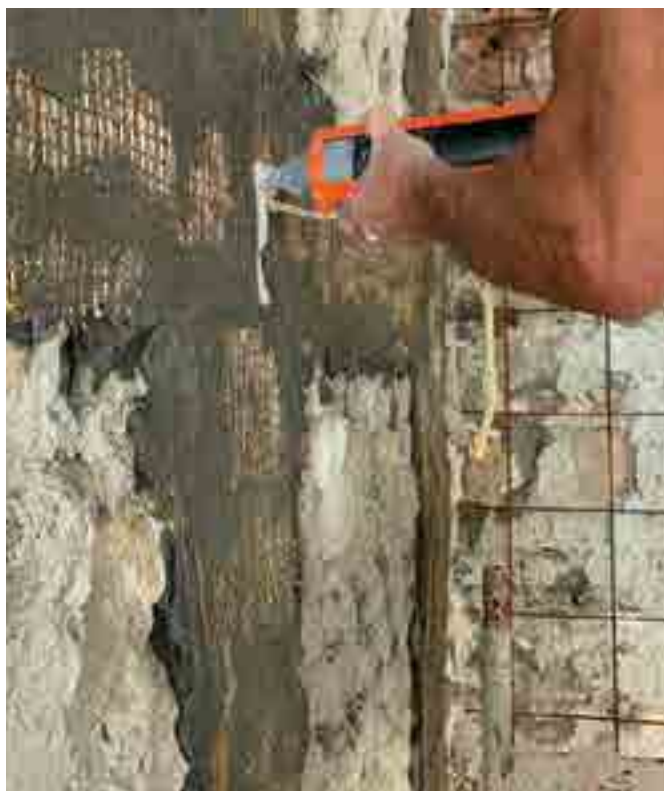
Posa del sistema FRCM con fibre in PBO Ruregold mediante applicazione della matrice inorganica MX-PBO Muratura e rete PBO-MESH. Nel dettaglio si vede la posa dei connettori PBO-JOINT.
