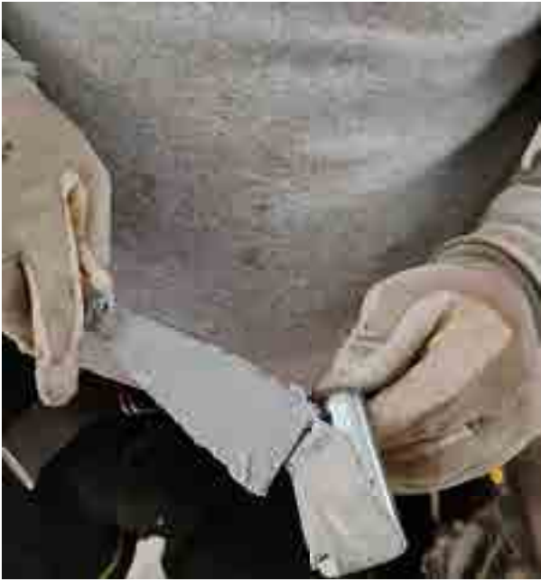
Consolidamento del solaio in acciaio con Connettore CentroStorico Acciaio Incollato. Dettaglio della stesura di Adesivo CentroStorico sul connettore.
