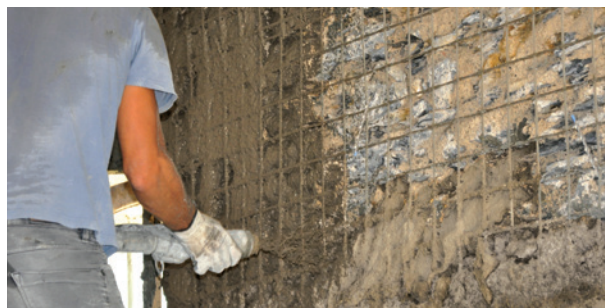
Sistema CRM con pompaggio su rete G-MESH 400/490 Ruregold
