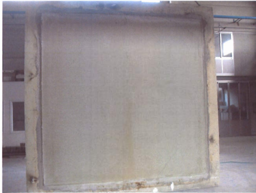
Fotografia della faccia esposta al fuoco del campione dopo la prova.
