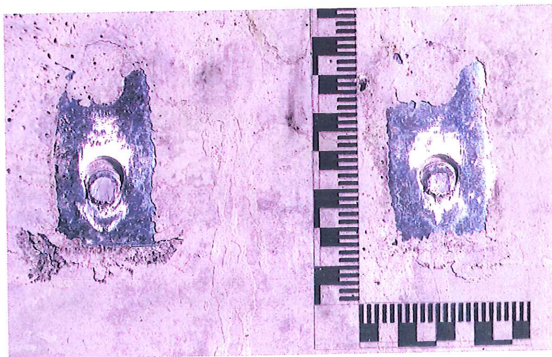
Fotografia 12: CS Steel campione 3 - aspetto della giunzione al termine della prova lato calcestruzzo.-
