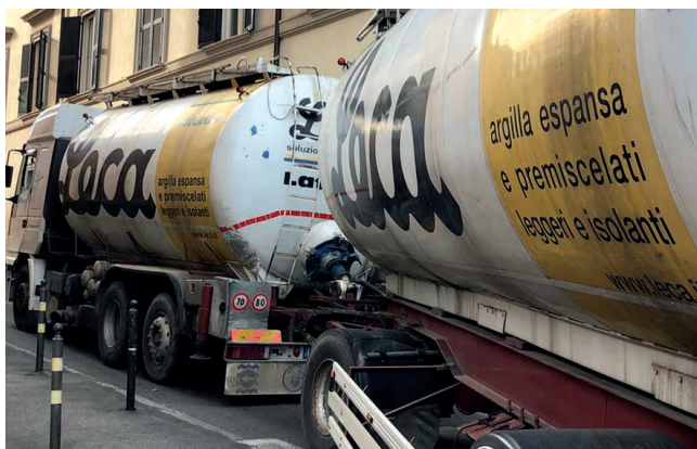
Cavity Filling sotto una scuola a Grottaferrata (RM).
