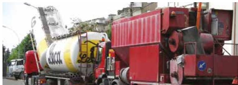
Cisterna di Leca Termopiù e impianto per la formazione della boiaccia cementizia.
