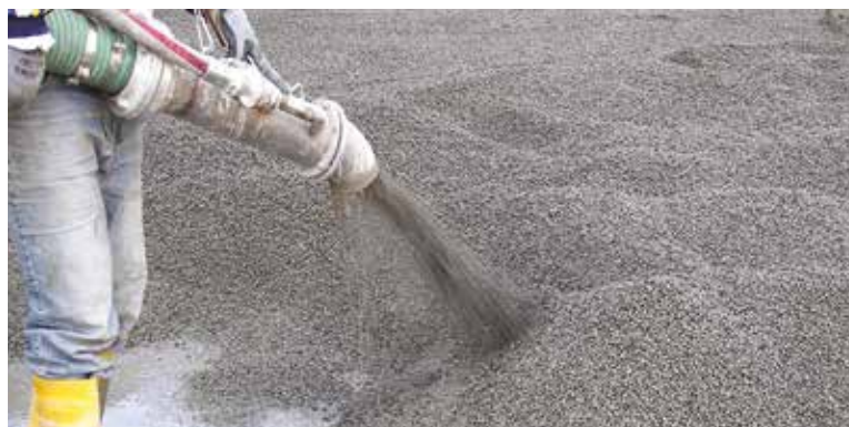
Pompaggio del Leca Termopiù.
